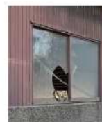
窓が割れた 管理不全空家
